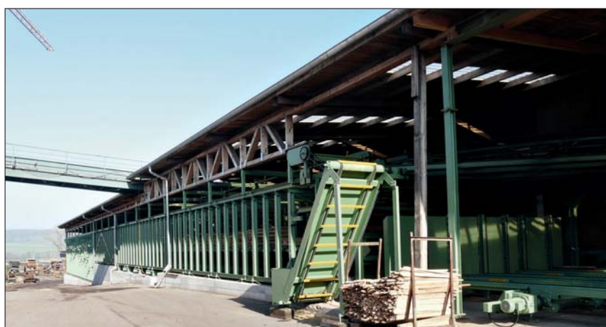
Das neue Brettensortierwerk mit 75 Boxen, teilweise manuelle Klappboxen, sonst automatisch entleerende Absenkböden. Man beachte die Höhendifferenz zwischen den beiden Teilen der Anlage aufgrund des Geländeprofiles.
